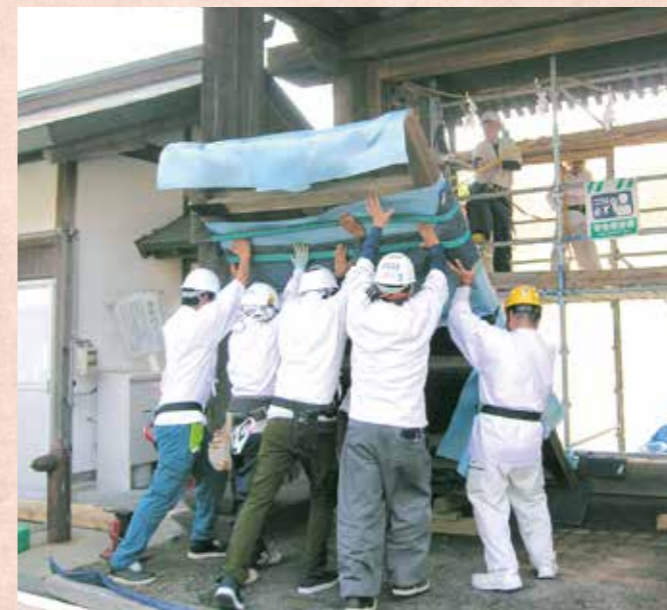
扉は一旦取り外し、割れていた扉の板を補修、錆びていた唄金物 ばいかな などは錆轉換の処置をした後に建て付け、左右の扉の高さを調整しました。
