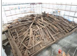
(解体時 小屋組破損状況)
